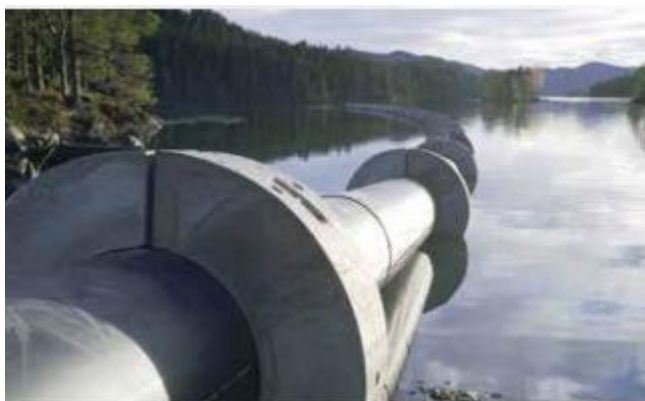
Inntaksledning i Benna.
