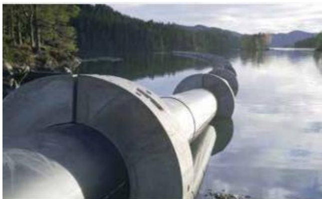
Inntaksledning i Benna.
