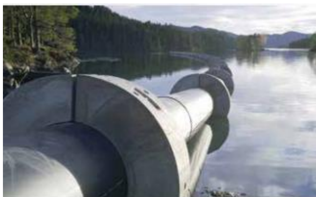
Inntaksledning i Benna.
